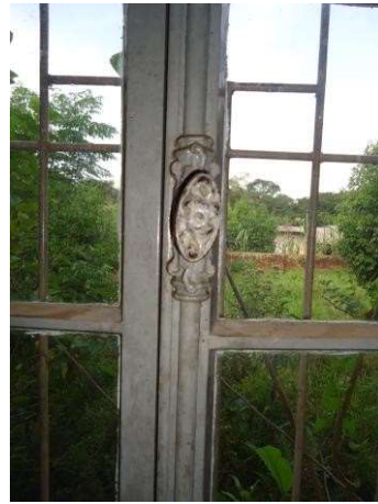
Ferragens das esquadrias.
