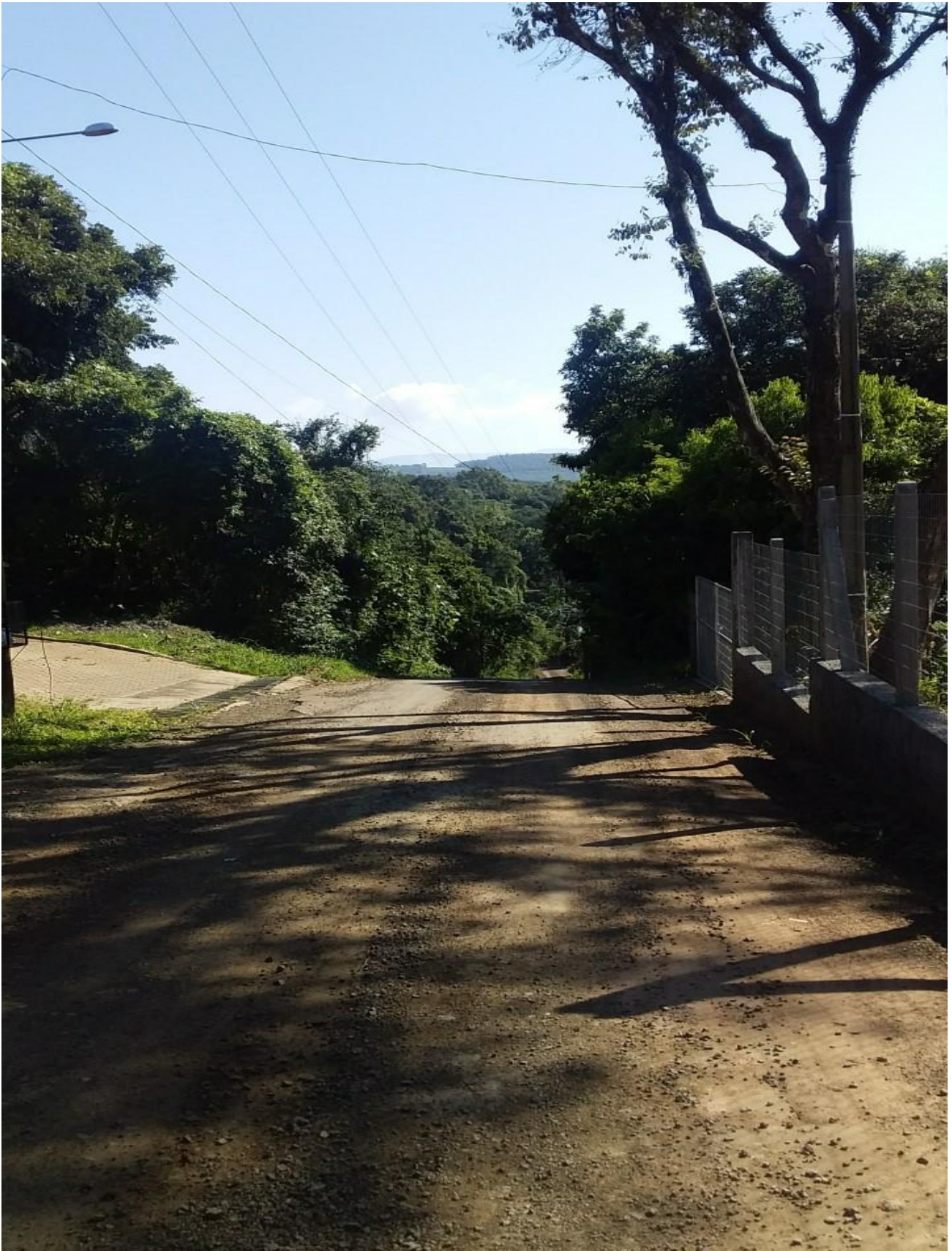
Correção da Inclinação do asfalto, para que a água não vá para o lado das casas.
